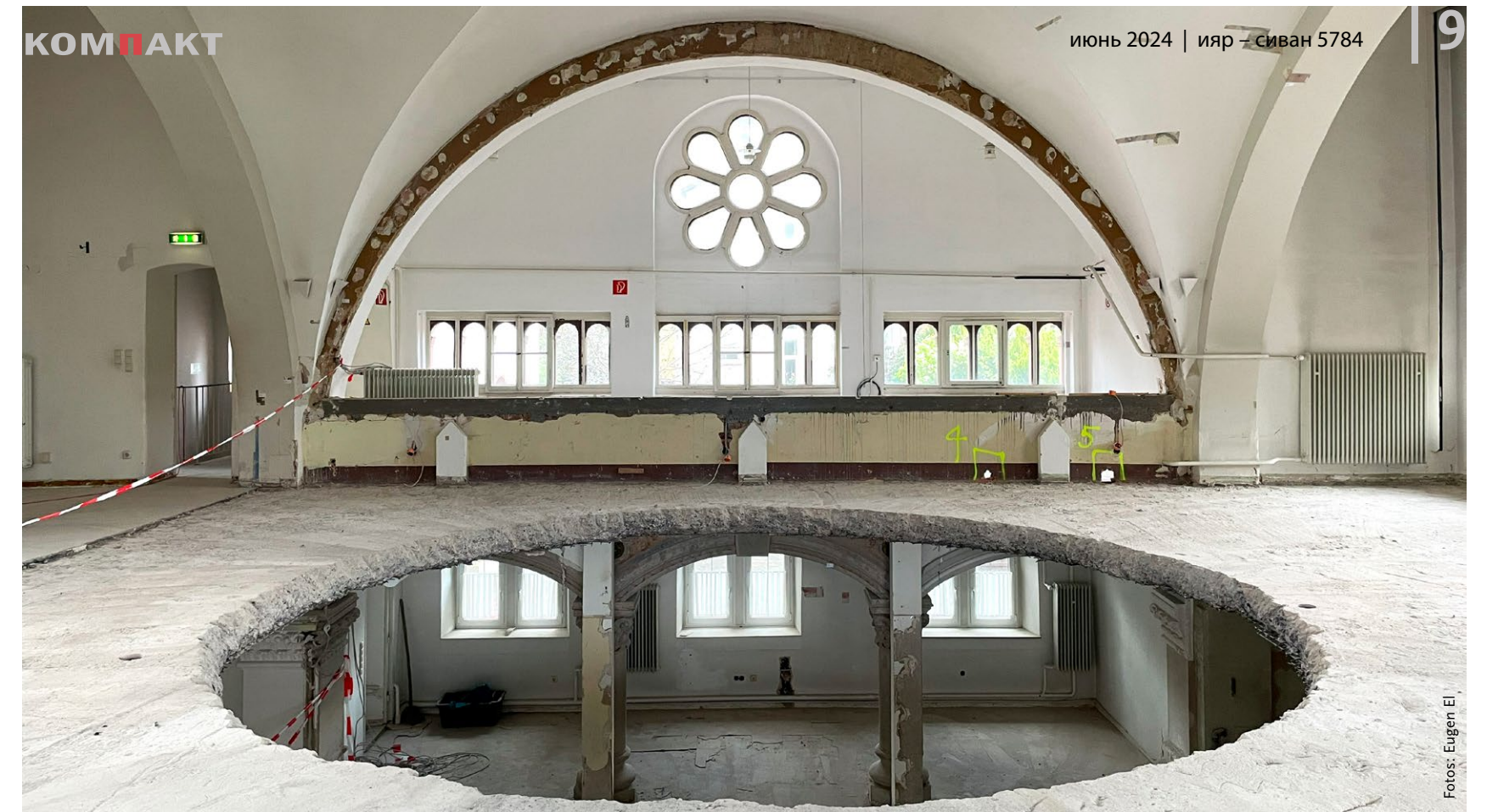
Innenansicht der Synagoge: In der Nachkriegszeit wurde auf Höhe der Frauenempore eine Stahlbetondecke eingezogen, in der jetzt ein großes Loch klafft.
