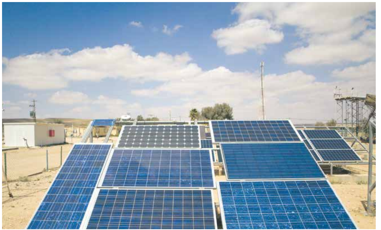
Kraft der Sonne: Fotovoltaikanlage in Israel | Foto: David Shankbone/CC-BY-SA-3.0/Wikimedia Commons
